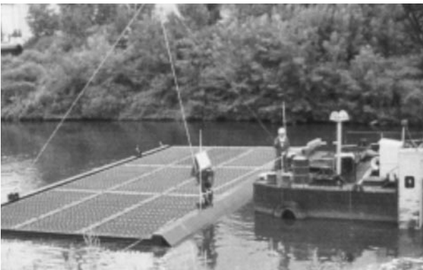
Reiner Sauerstoff für Fließgewässer: Begasungsmatten werden auf den Grund abgesenkt.
